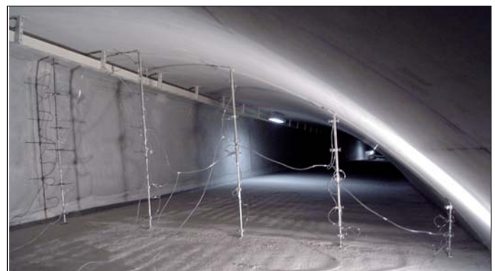
Obr. 4 Měřicí síť v potrubí odsávacího větrání Fig. 4 Measuring grid in exhaust air duct
